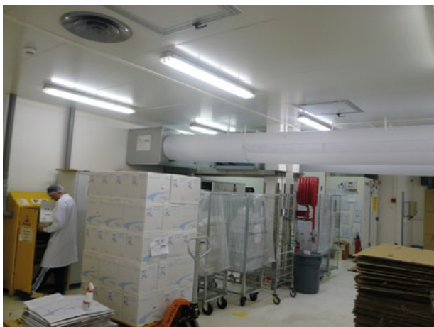
Décontamination de l'air d'une salle d'emballage (700 m³) par 2 Compact AirPur
